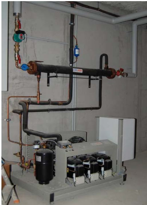
Zentrale für Kühlaggregate samt Wärmerückgewinnung zur Vorwärmung von Warmwasser
