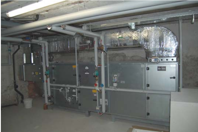
Lüftungsanlage mit Wärmerückgewinnung
